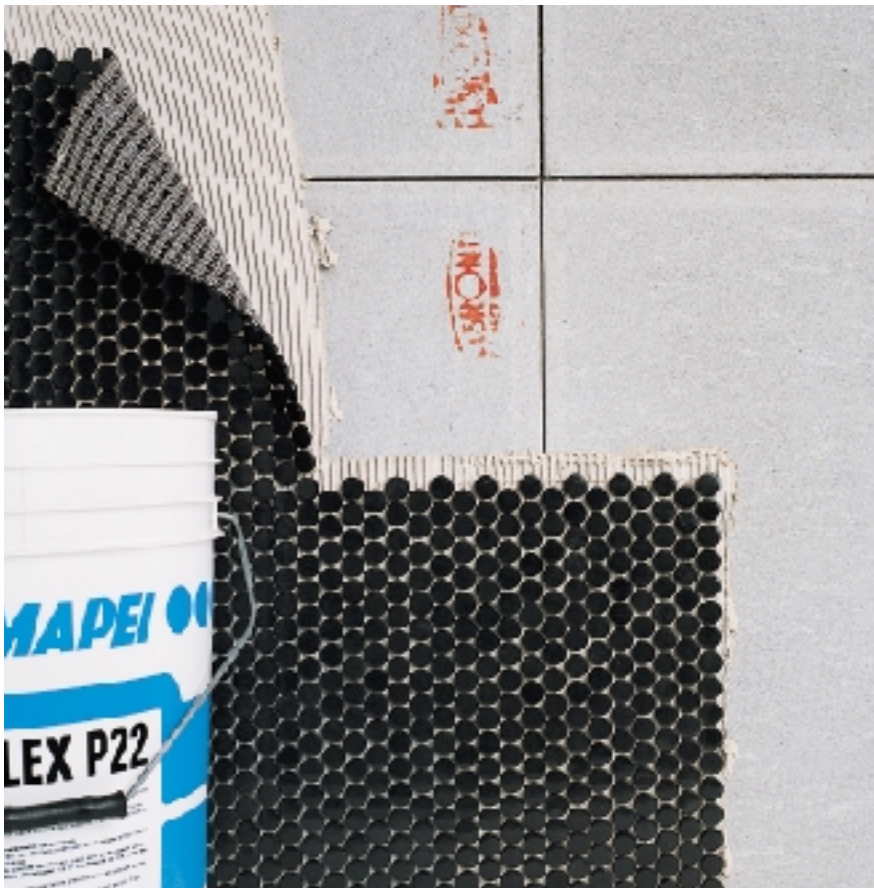
Assentamento sobre fibrocimento
