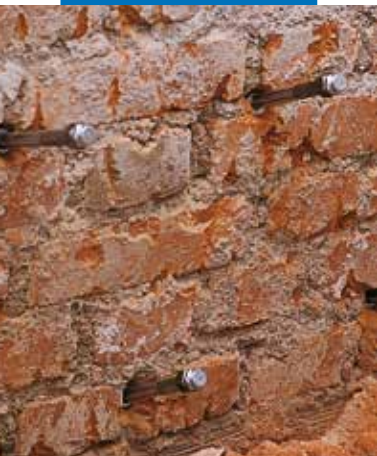
Detalhe dos injetores utilizados
